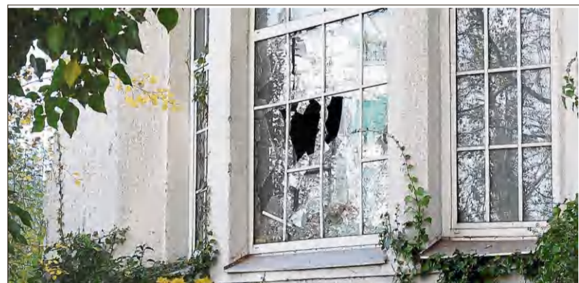
Manche Fenster wurden bereits Opfer von Vandalismus.
